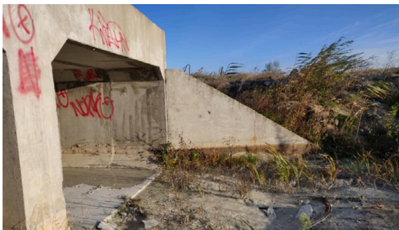
Рис. 4. Отсутствие укрепления выходного лотка.
