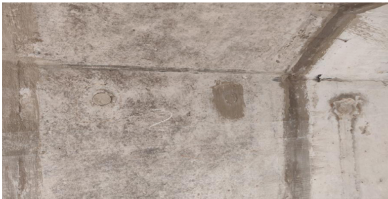
Рис. 5. Разрушение заделки шва между выходным звеном и от- крылками.
